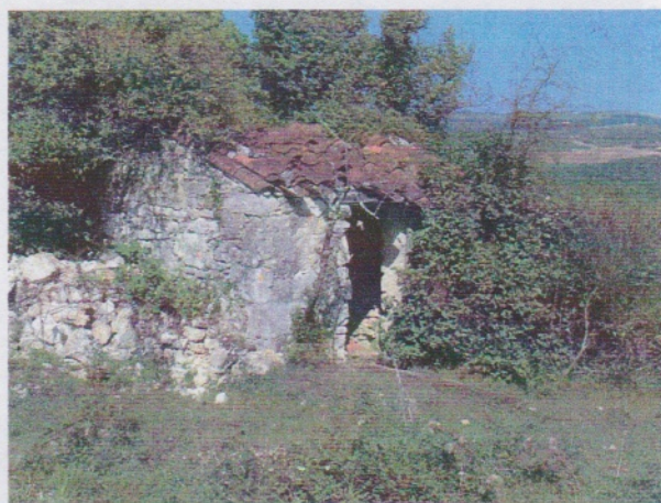
Abris de berger appartenant à M r Auguste RIGAL située à Puech Gaubel, possédant une couverture en tuile. ⑤
